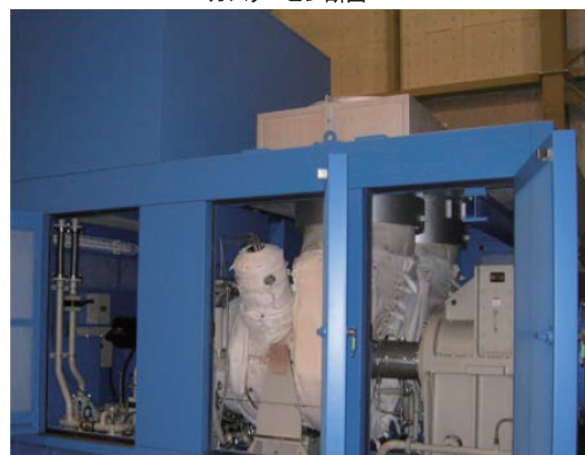
Packaged CNT-4002MN Pump drive unit 図 14 新潟原動機 CNT-4002MN 2,000PS /4,000PS ポンプ駆動用ガスタービン、CIMAC 2013 上海大会 13)
